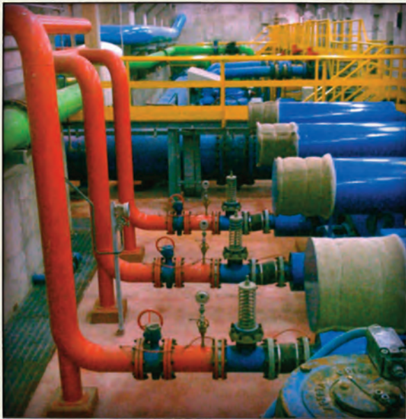
Potabilizzatore Sambuca, Sollevamento Montescuro Ovest
