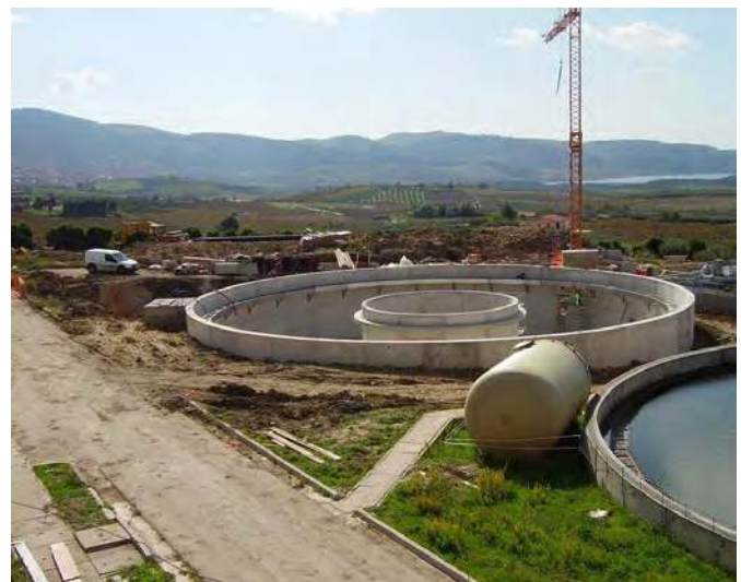
POTENZIAMENTO DELL'IMPIANTO DI POTABILIZZAZIONE DI SAMBUCA
